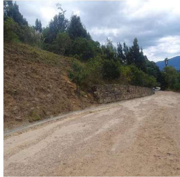
Figura 24. Presencia de unidad geotécnica de piedemonte, sostenidas por gaviones ubicados en paralelo a la vía.
