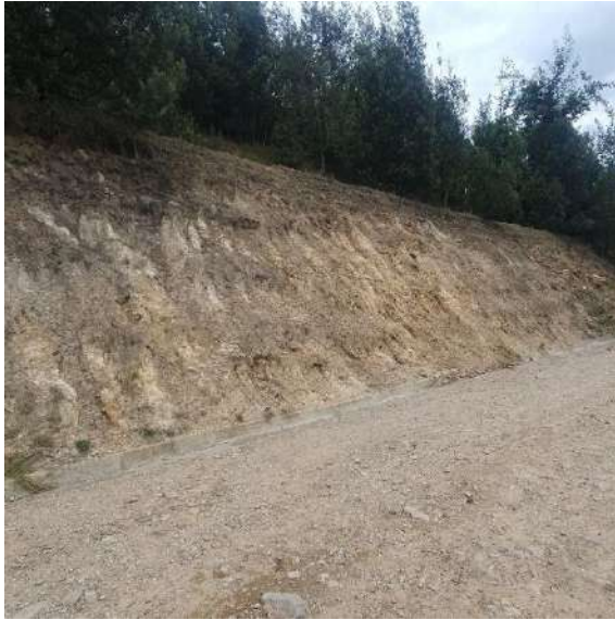
Figura 23. Presencia de unidad geotécnica de roca, aflorando por la construcción de la vía que atraviesa el cerro.
