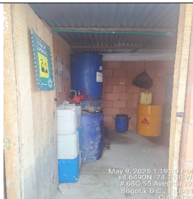
Fotografía No. 7. Adecuado almacenamiento de sustancias químicas y/o peligrosas.
