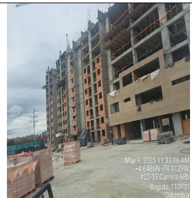
Fotografía No. 8. Edificaciones de más de tres pisos sin adecuado cerramiento de fachadas.
