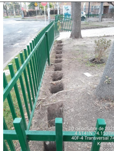
Foto 8. Vista detalle de deterioro de zona verde y endurecimiento.
