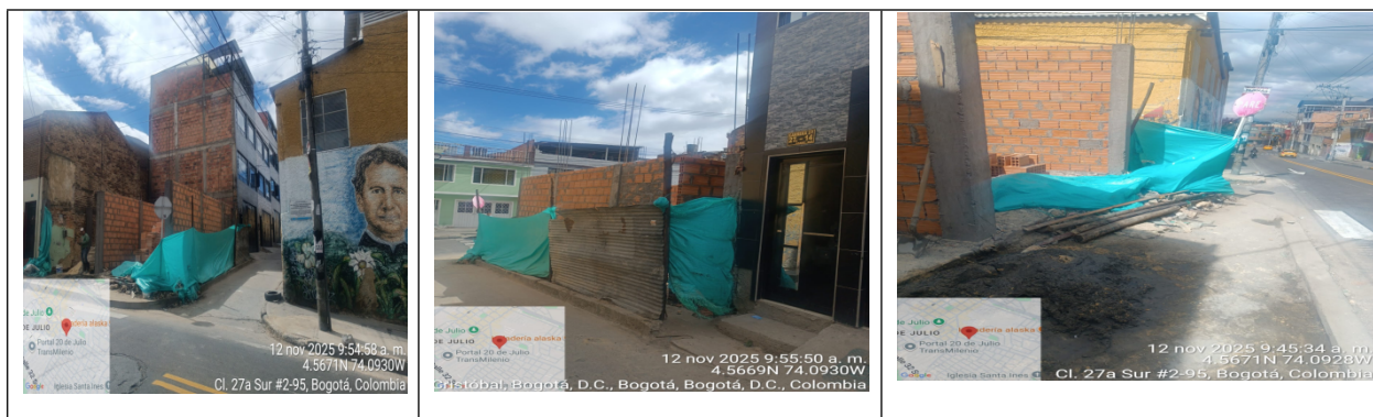
Fotografías No. 1, 2 y 3. Vista general externa y licencia de construcción presentada. Fuente. Subdirección del Recurso Suelo – Visita del 12 de noviembre de 2025.
