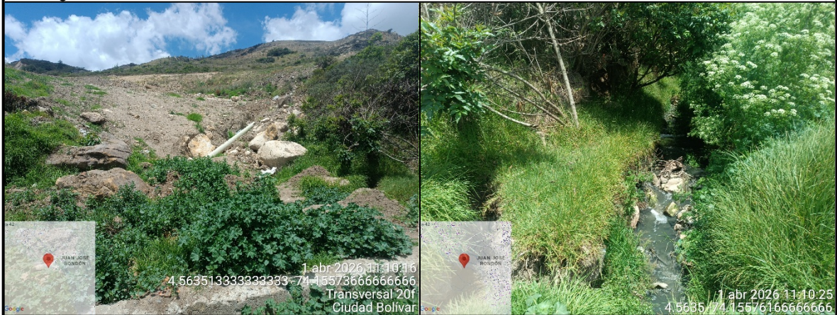
Fotografías 5 y 6. Evidencia de actividades constructivas asociadas presuntamente a sistemas de descargas de alcantarillado (Punto 2) y evidencia de residuos pétreos sobre el lecho de la quebrada Trompetica, en el segmento posterior a la zona de construcción.
