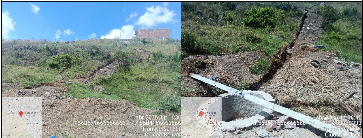
Fotografías 3 y 4. Evidencia de actividades constructivas asociadas presuntamente a sistemas de descargas de alcantarillado, asimismo, se observa la adecuación de zanjas y pozos de inspección (Punto 1) sin flujo y cuyo punto de descarga final se desconoce.
