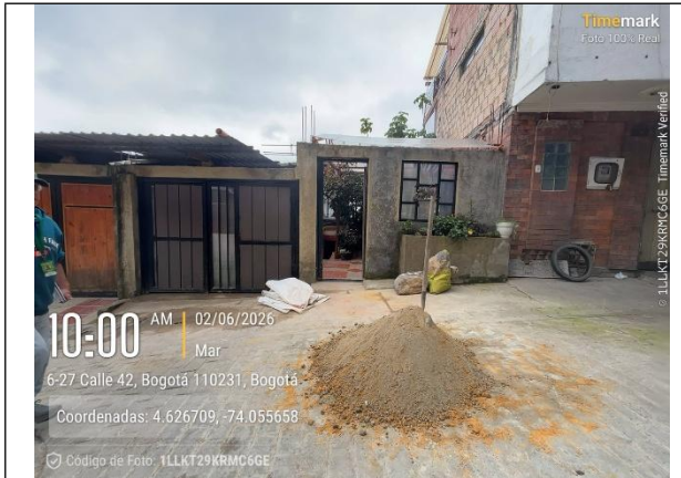
Fotografía No. 3 Presencia de materiales de construcción sobre el espacio público.
