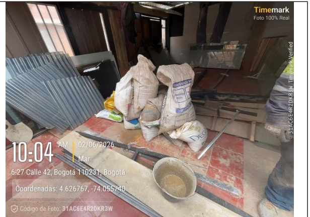
Fotografía No. 4 Presencia de materiales de obra dentro de vivienda.
