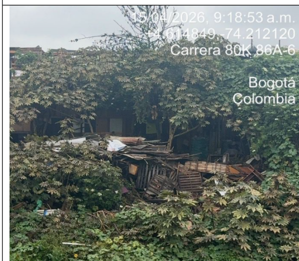
Fotografía 3. En las coordenadas 4,6153890, -74,2120859 se evidencia ocupación de la ronda hídrica mediante la instalación de estructuras no convencionales.
