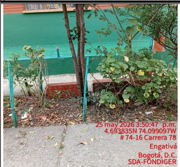
Foto 6: Vista detalle de la afectación a la placa de concreto.
