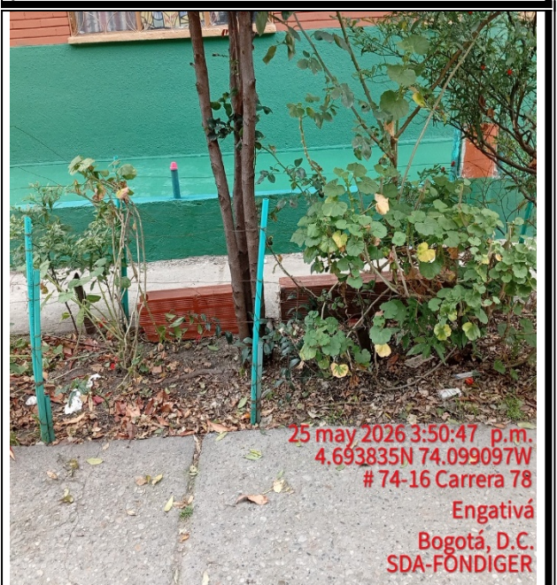
Foto 6: Vista detalle de la afectación a la placa de concreto.
