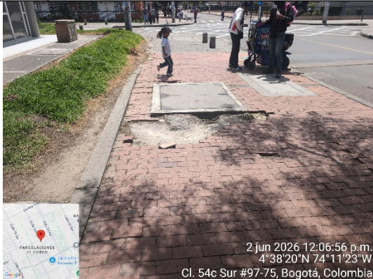
Fotografía 1: Afectaciones zona peatonal
