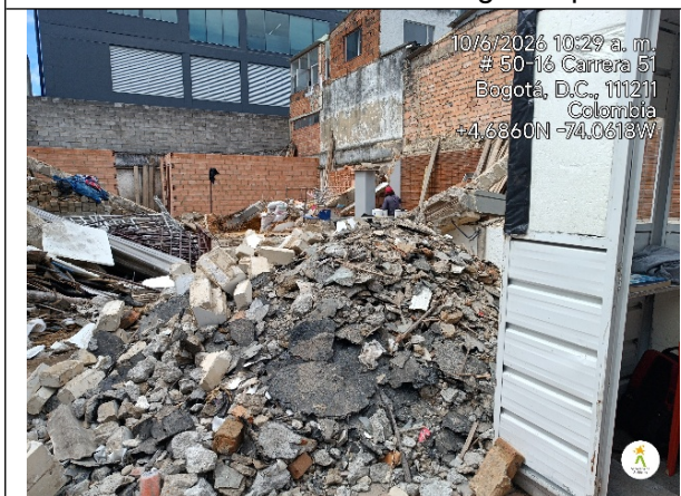
Imagen 3. Acopios de residuos y construcción de muros en la parte posterior del lote.
