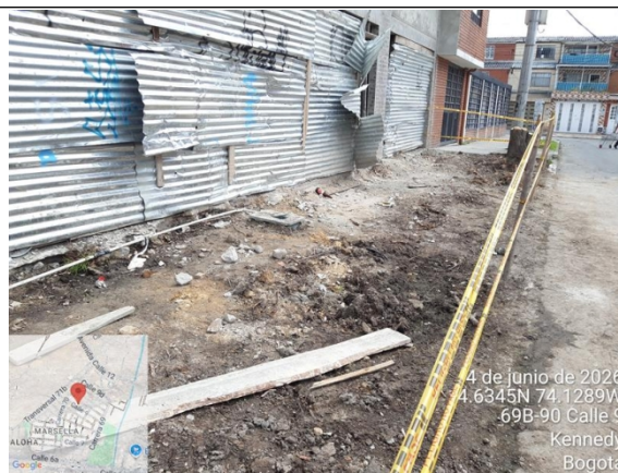
Foto 4. Vista general #2 del deterioro a zona verde de espacio público del costado oriental de la dirección.
