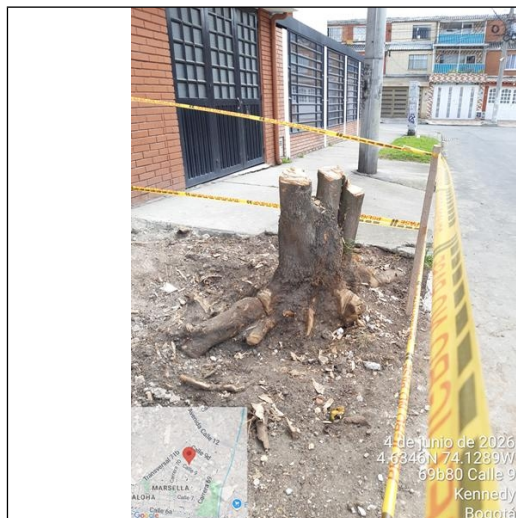
Foto 5. Vista general de árbol de urapán en espacio público con intervención antitécnica.
