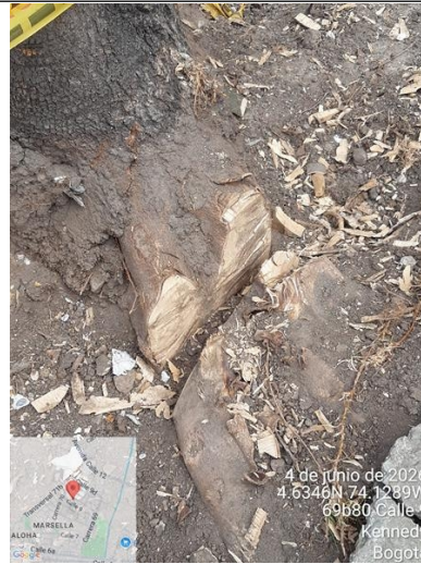
Foto 6. Vista detalle de árbol de urapán en espacio público con intervención antitécnica.
