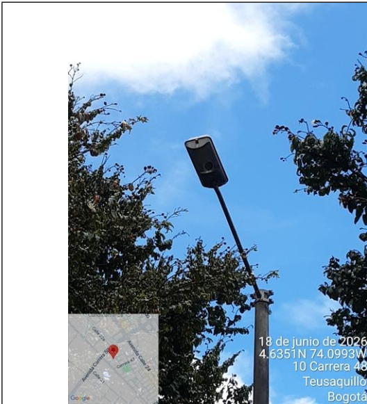
Foto 5. Estado actual de luminaria #1 observada en el sector.
