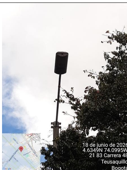
Foto 6. Estado actual de luminaria #1 observada en el sector.
