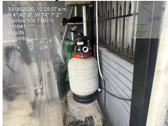
Fotografía 6. Filtro de arena
