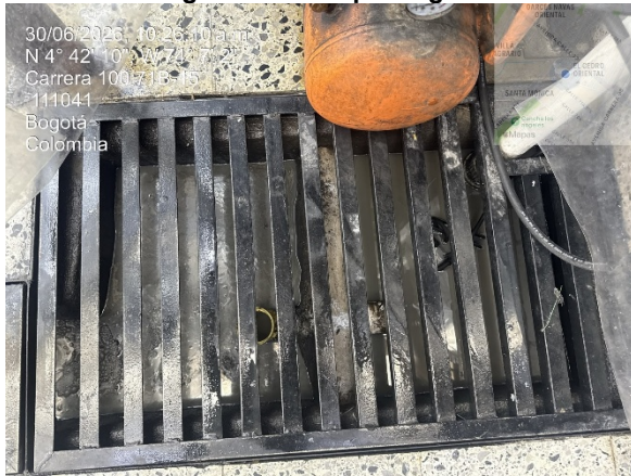
Fotografía 5. Trampa de grasas
