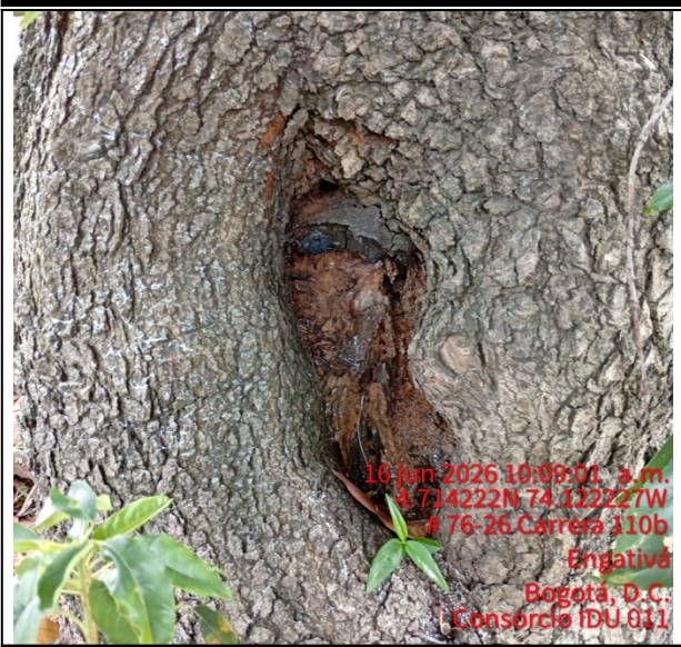
Foto 4: Vista detalle pudrición en fuste.
