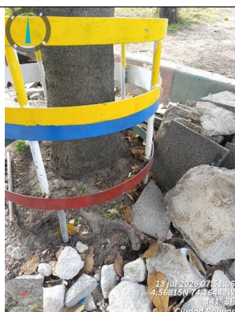
Foto 2. Vista afectación radicular.
