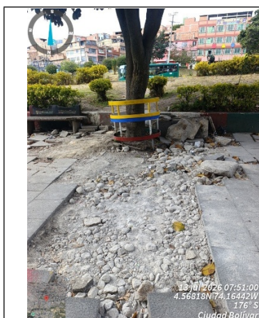
Foto 1. Vista afectación a espacio público.
