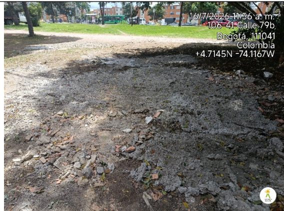
Imagen 2. Sobrante de concreto y RCD en el frente de la vivienda.
