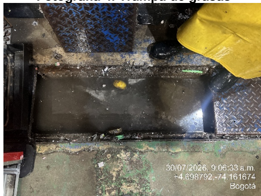
Fotografía 4. Trampa de grasas
