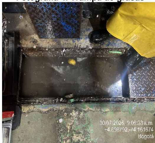
Fotografía 4. Trampa de grasas
