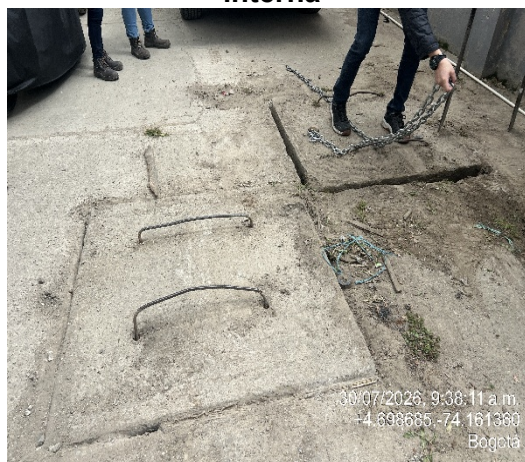
Fotografía 6. Cajas de inspección interna
