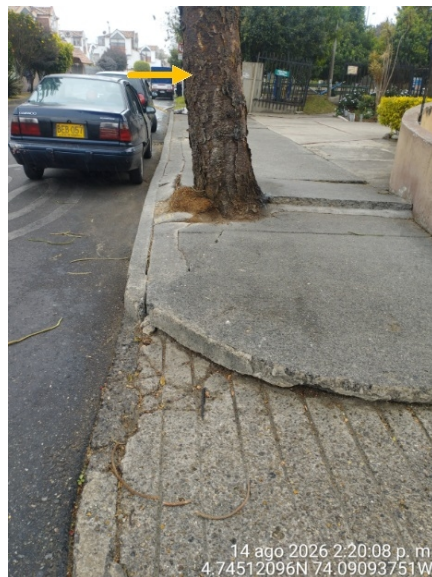
Foto 6. Araucaria ( Araucaria excelsa ) Se observa el levantamiento del andén
