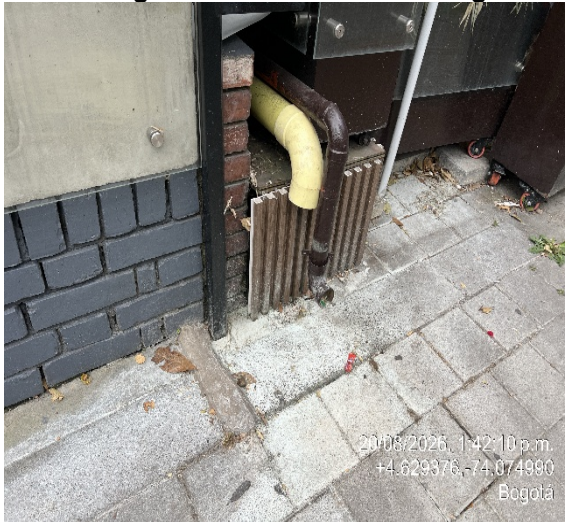
Fotografía 3. Tubería de descarga
