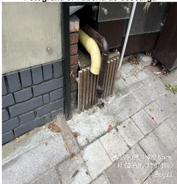
Fotografía 3. Tubería de descarga
