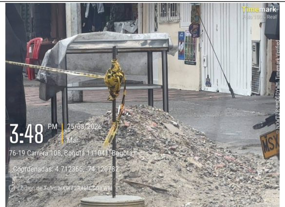
Fotografía 2. Residuos de construcción y demolición en la parte frontal del predio.
