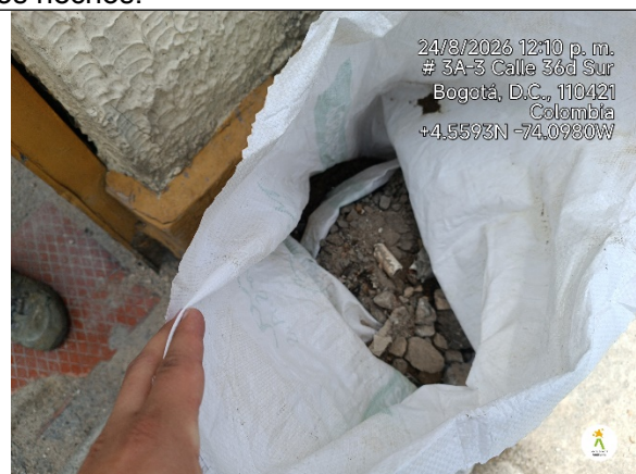
Imagen 4. Tipo de residuos acumulados dentro de las lonas.
