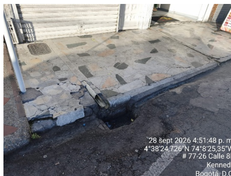
Fotografía No. 4 Tubería con salida hacia la vía pública - establecimiento Big Fish
