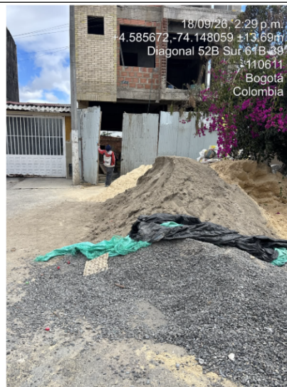
Fotografía 4. Acopio de materiales en espacio público
