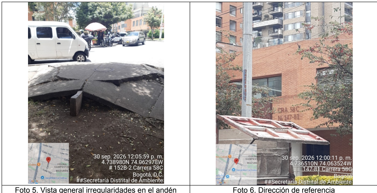
Foto 5. Vista general irregularidades en el andén
