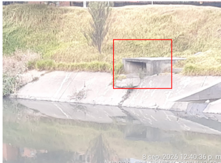
Fotografía 9. Estructura asociada a la red troncal pluvial CSF-RFU-0840 (04°39'30.473"N; 74°07'46.868"W).
