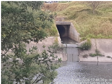
Fotografía 12. Estructura asociada a la red troncal pluvial CSF-RFU-0880 (04°39'26.550"N; 74°07'52.541"W).
