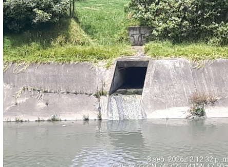
Fotografía 7. Estructura asociada a la red troncal pluvial CSF-RFU-0700 (04°39'32.223"N; 74°07'23.741"W).
