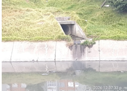
Fotografía 10. Estructura asociada a la red troncal pluvial CSF-RFU-0850 (04°39'30.503"N; 74°07'48.598"W).
