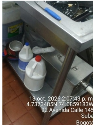
Fotografía 2. Trampa de grasa
