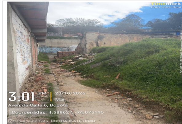
Fotografía 1. Residuos de construcción y demolición acopiados en espacio público.
